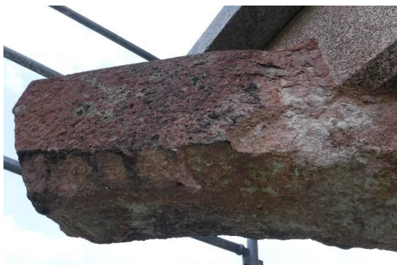
身を乗り出した作業では十分な修理は出来ていない
