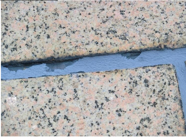
▲ 補修前の目地状況
