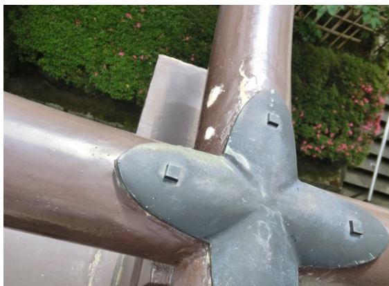
白い部分が修理跡
