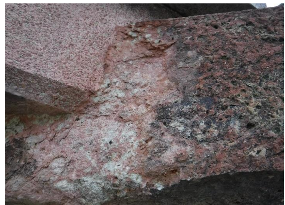
剥離、亀裂、空隙が存在
