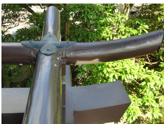
白い部分が修理跡
